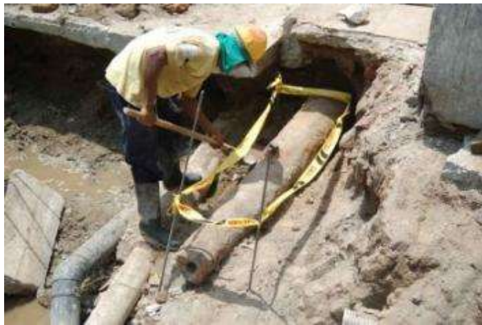
Aspecto del segundo cañón hallado en la esquina de la calle de la Acequia con el callejón de la Catedral. Aparenta mejores condiciones que el otro cañón encontrado, quizás por estar más lejos del mar y de su nivel freático.
